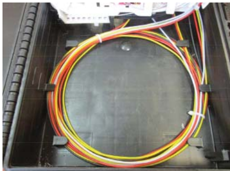
Рисунок А3 – Уложенный запас длин «транзитных» ОК на задней стенке корпуса муфты-креста между направляющими
